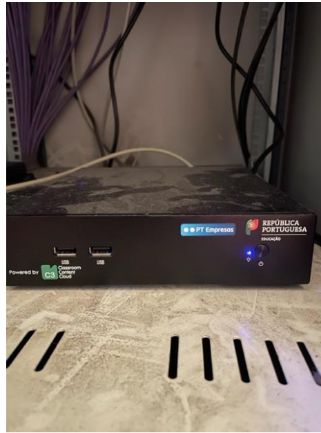
Foto 5 – Instalação de backup de fibra ótica
